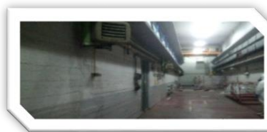
Impianto di Trisaia Corridor – trattamento rifiuti pregresse attività di esercizio
