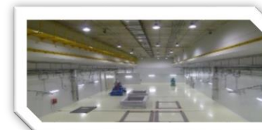
Impianto di Saluggia Deposito D2 e cabina elettrica
