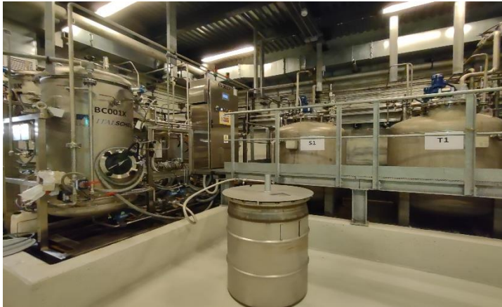
Realizzazione del nuovo sistema di trattamento degli effluenti liquidi radioattivi, denominato Radwaste
